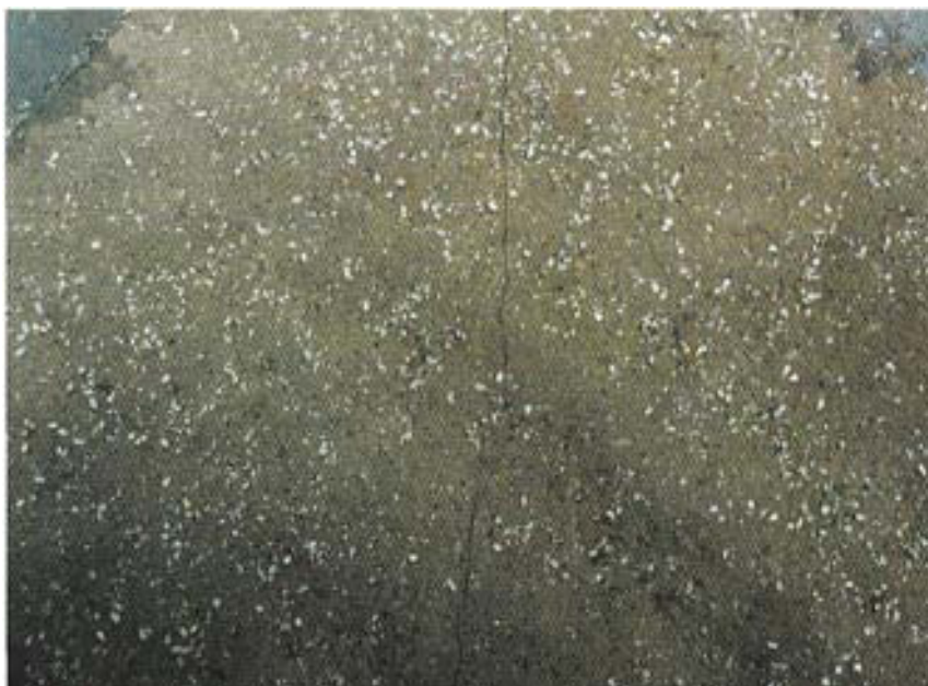
Figur 2. Revner i tagpap foranlediget af isspændinger.
